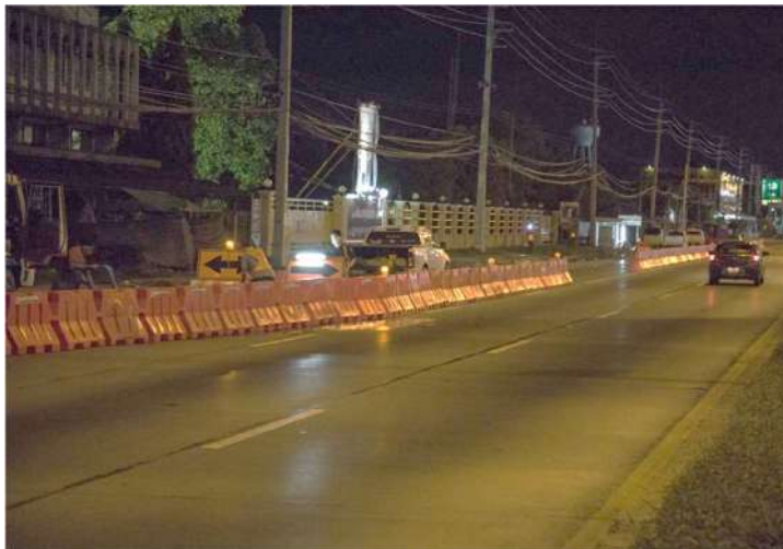
รูปที่ 5.6 การติดตั้งไฟแสงสว่างและไฟสัญญาณจราจรในเวลากลางคืน
