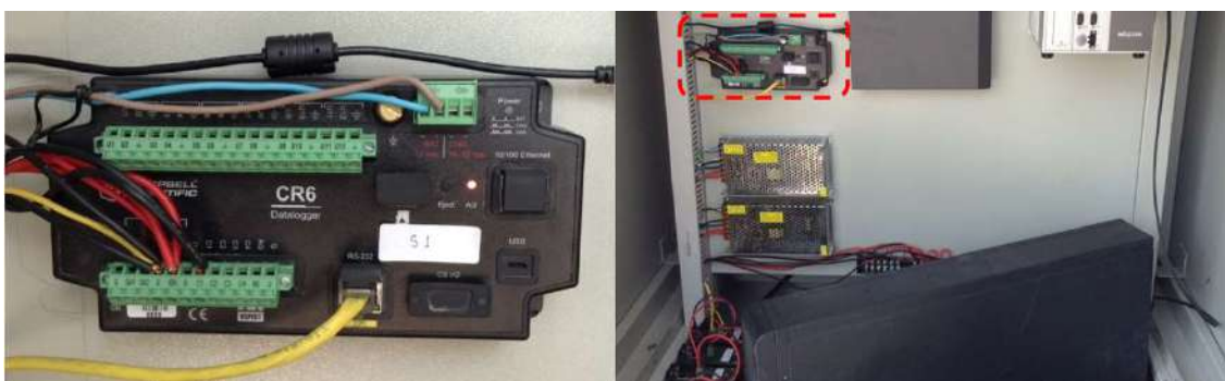
รูปที่ 5.56 อุปกรณ์บันทึกข้อมูล (Data Logger) แปลงตรวจวัดโครงสร้างถนนคอนกรีต
