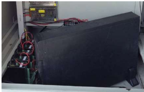
รูปที่ 5.62 อุปกรณ์ UPS แปลงตรวจวัดโครงสร้างถนนคอนกรีต
