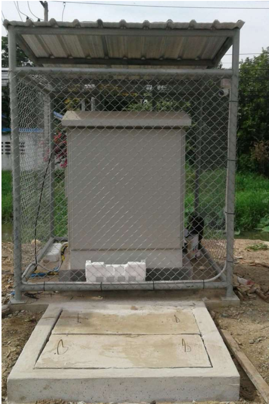
รูปที่ 5.104 ตู้ควบคุมและบ่อกักสายสัญญาณแปลงตรวจวัดโครงสร้างถนนลาดยาง
