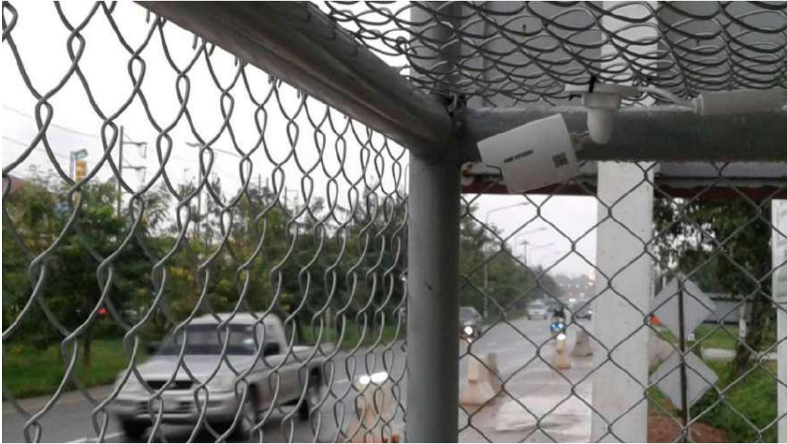
รูปที่ 5.111 กล้องวงจรปิด (CCTV) แปลงตรวจวัดโครงสร้างถนนลาดยาง
