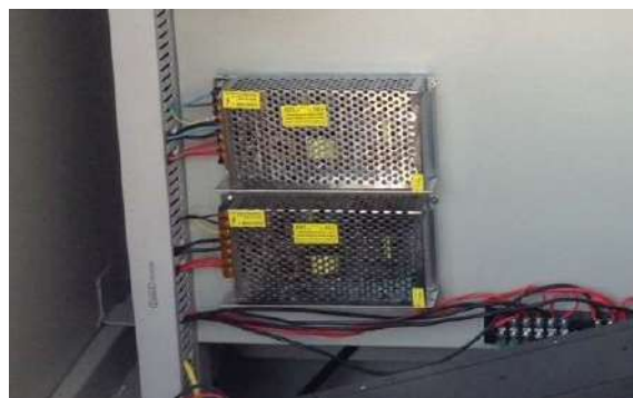
รูปที่ 5.61 อุปกรณ์แปลงไฟฟ้ากระแสสลับเป็นไฟฟ้ากระแสตรงแปลงตรวจวัดโครงสร้างถนนคอนกรีต
