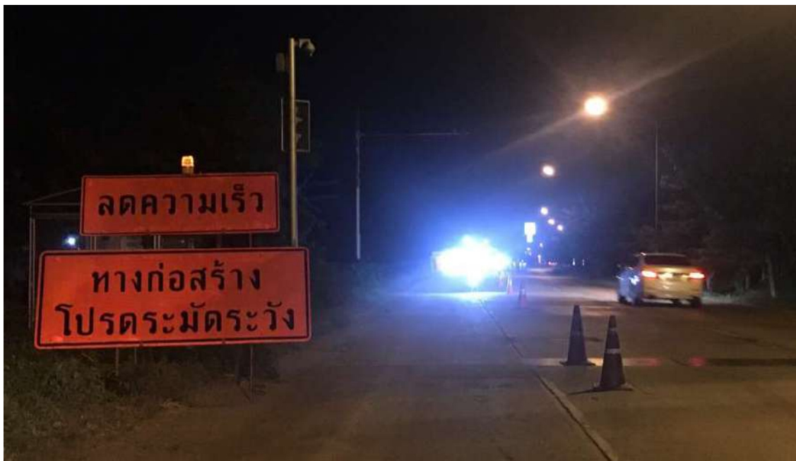
รูปที่ 5.68 การติดตั้งไฟแสงสว่างและไฟสัญญาณจราจรในเวลากลางคืน
