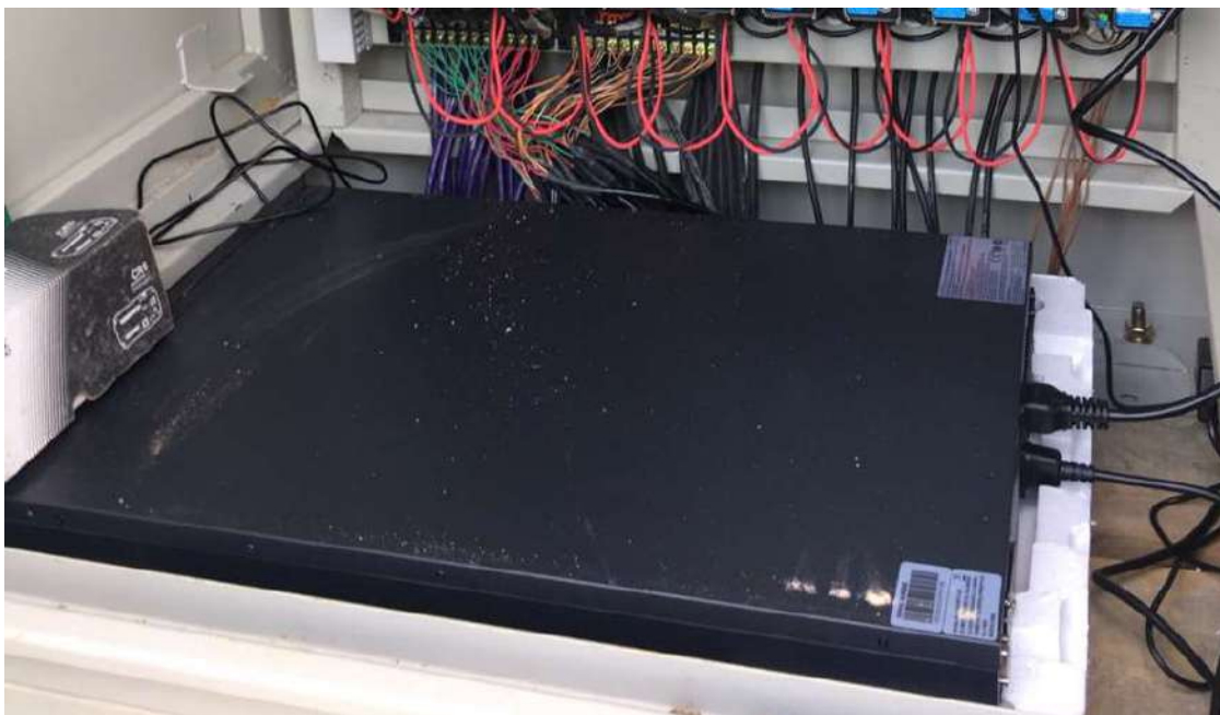
รูปที่ 5.108 อุปกรณ์ UPS แปลงตรวจวัดโครงสร้างถนนลาดยาง
